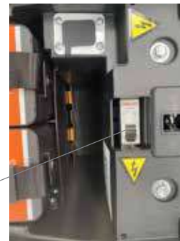
INTERRUPTORE GENERALE OFF
