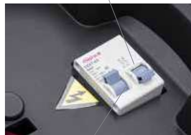
INTERRUPTORE GENERALE "OFF" BATTERIA 2
