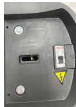
INTERRUTTORE GENERALE ON
