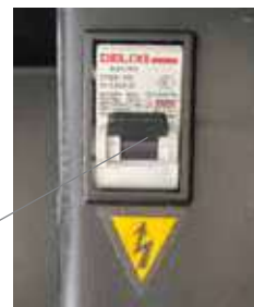
INTERRUPTORE GENERALE ON
