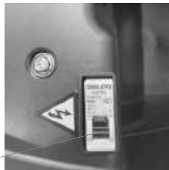
INTERRUTTORE GENERALE ON
